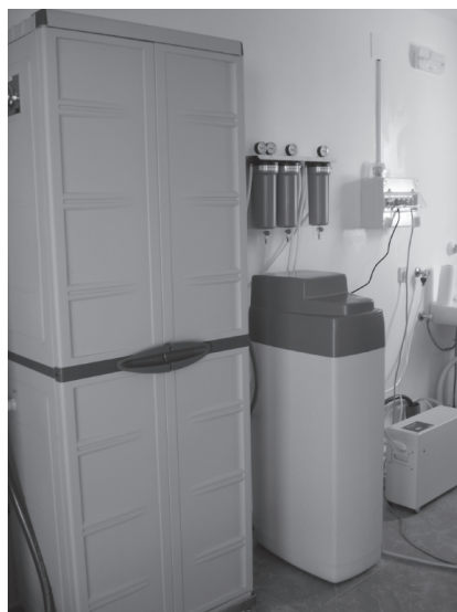
Planta de agua
