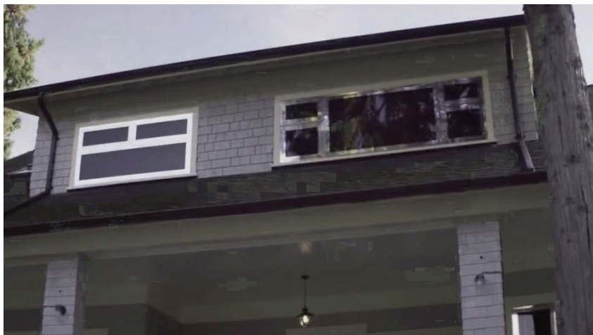
Protecciones especiales en la casa para evitar el ingreso de los rayos ultravioletas.
